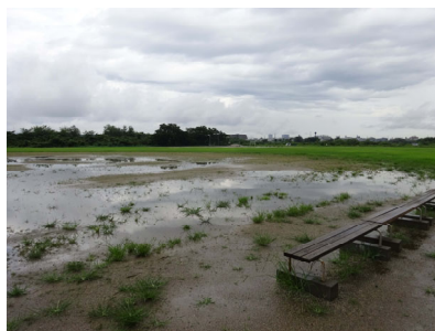
グラウンド（舗装） 水はけが悪い
