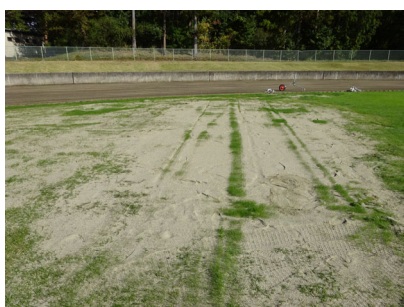
フィールド競技：走幅跳 踏切板、砂場枠組み欠損
