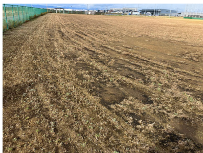
グラウンド（舗装） 部分的に水はけが悪い
