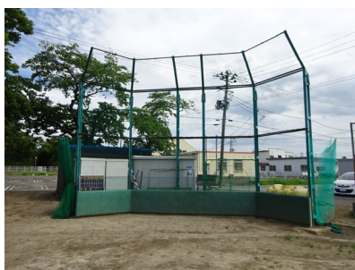
バックネット 鉄部の腐食
