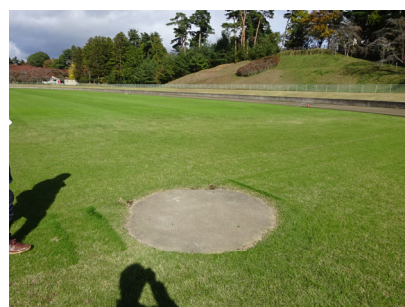
フィールド競技：砲丸投 砲丸投サークルの埋没
