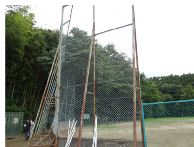
バックネット 鉄部の腐食
