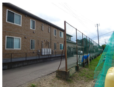
フェンス 鉄部の腐食
