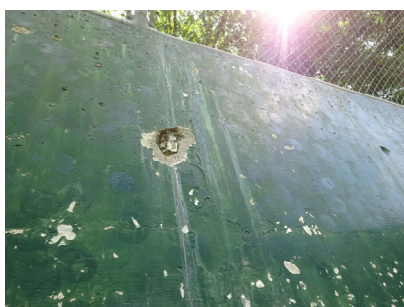
壁打ち 壁面の損傷
