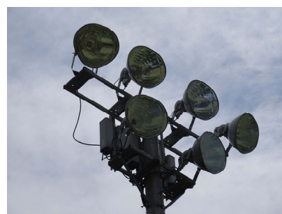
照明灯 LED 照明に交換要す
