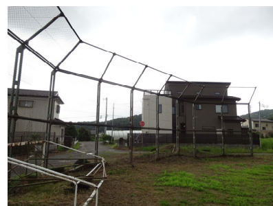
バックネット 鉄部の腐食
