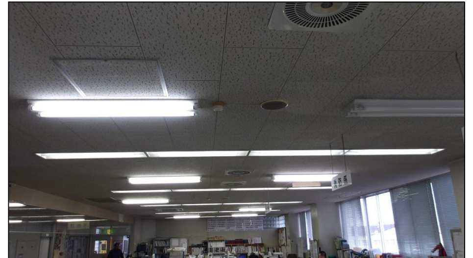
消防本部事務室内の状況
